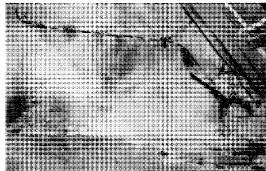
Abb. 12 5,5 m der 7 mm 2 starken eisernen Erdungsleitung wurden verdampft
