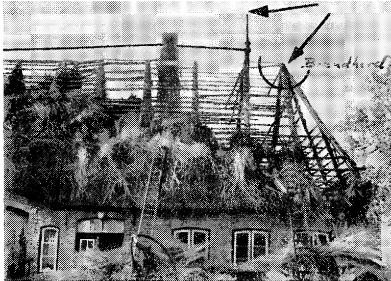
Abb. 3 Blitzschlag in ein Bauernhaus mit unvollständiger Blitzschutzanlage
