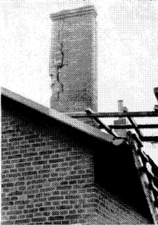
Abb. 9 Durch Blitzstrom verursachter Mauerriß
