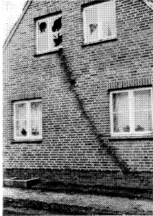
Abb. 10 Durch Blitzstrom beschädigte Giebelwand
